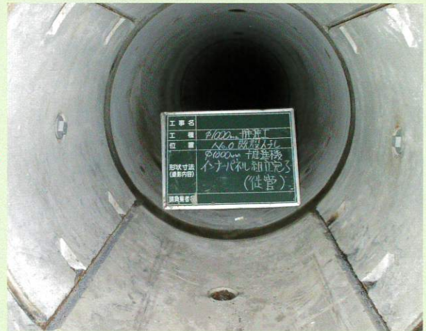
掘進機外殻にインナーパネルを設置 (写真は目地仕上げ前)
