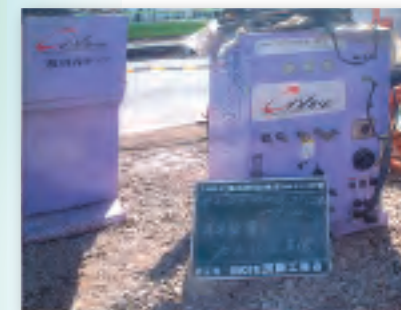
油圧ユニット・操作盤
